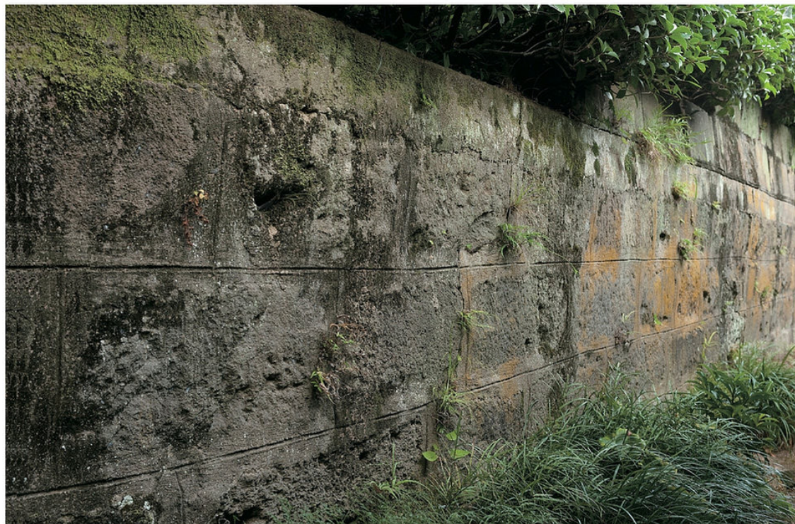
末宗組創業の地の象徴だった猫間橋の石は、末宗邸の塀の一部となって、今も歴史を刻み続けている。
